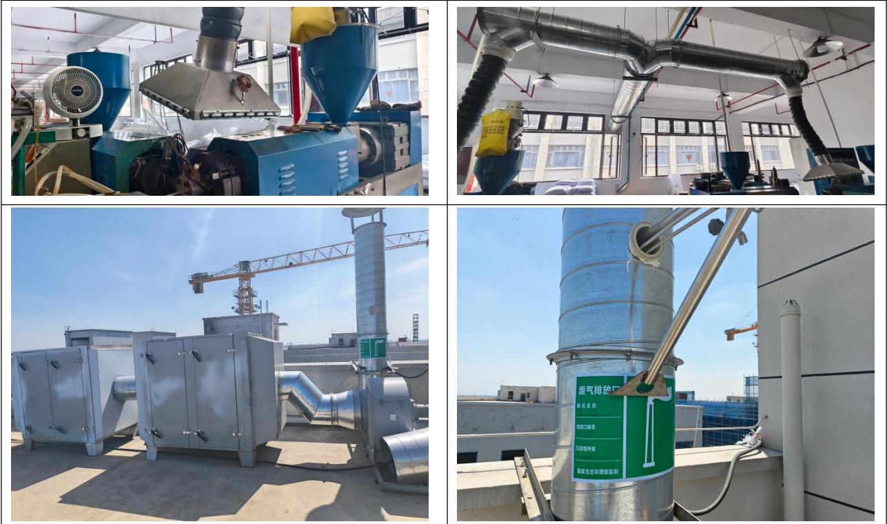
图 3.2-1 挤出机收集处理设施照片
