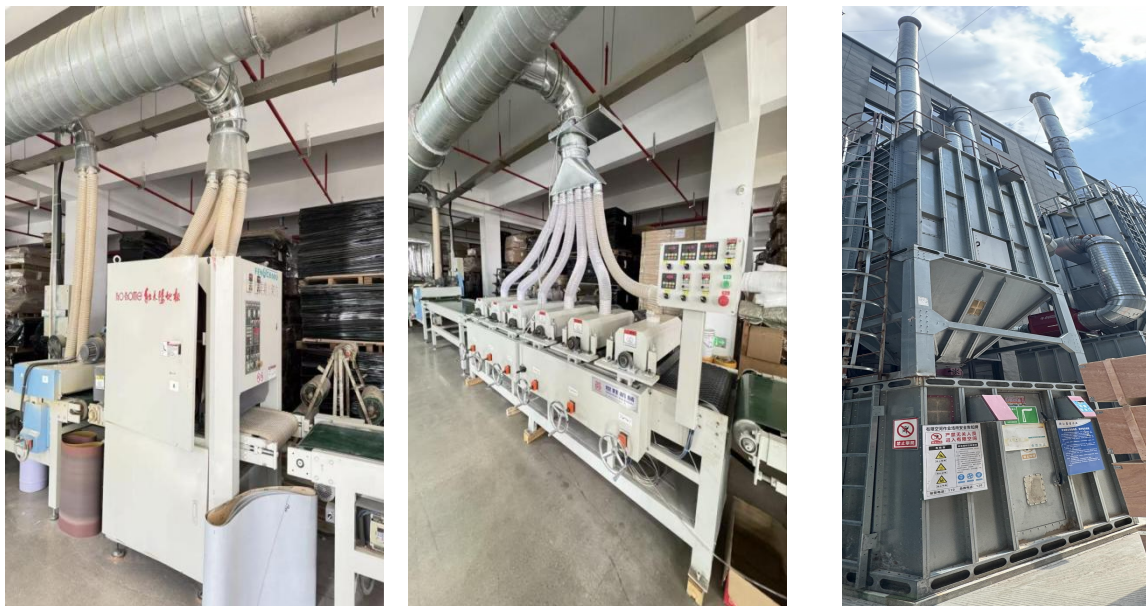
图 3-1 生产车间 4 层砂光、拉丝废气收集+处理设施及排气筒实拍图
