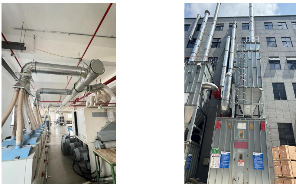
图 3-2 生产车间 5 层双端铣、四面刨、拉丝机废气收集+处理设施及排气筒实拍图
