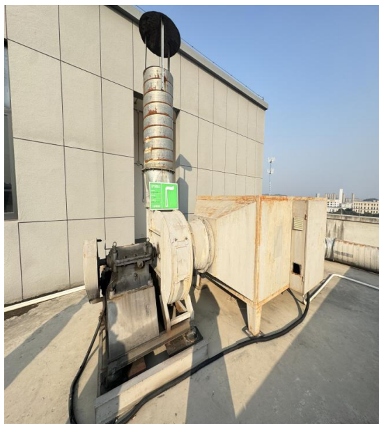
图 3-5 生产车间 4 层有机废气处理设施及排气筒实拍图
