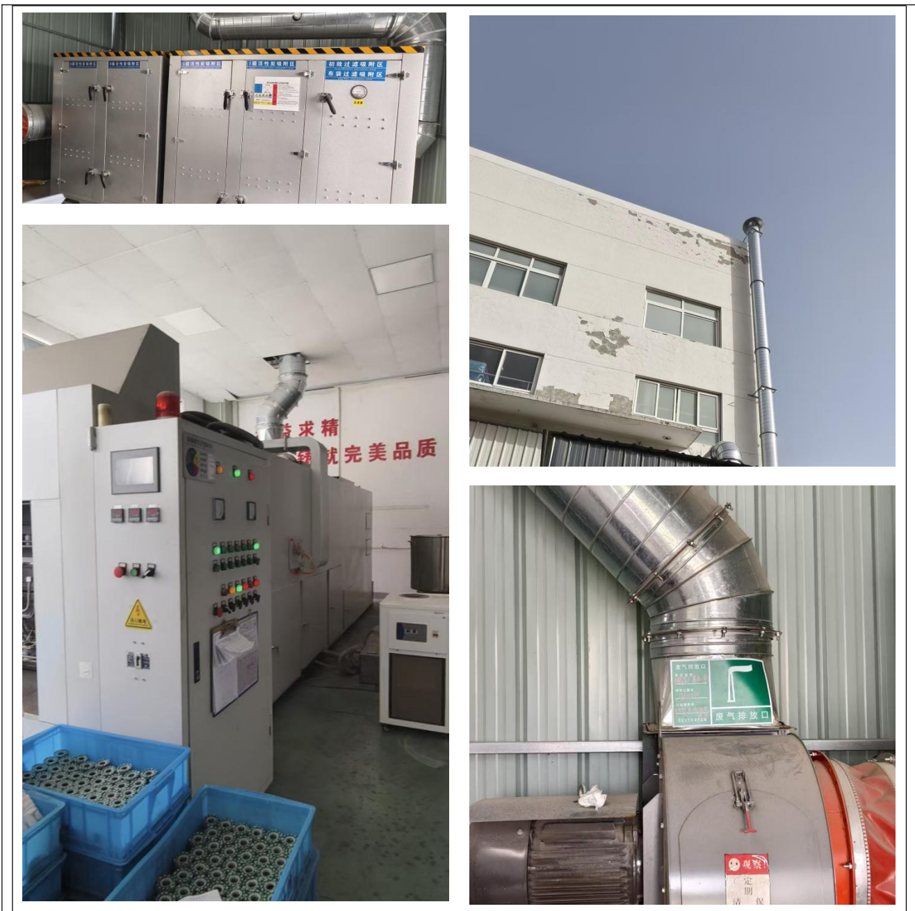
图 3.2-2 浸漆、烘干废气收集处理设施照片
