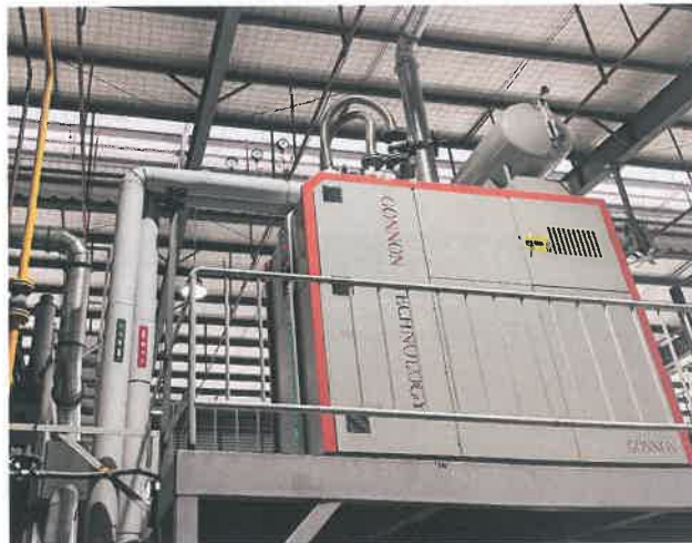
图 4-2 模温机燃气废气处理设施
